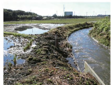
崩落した排水路法面
