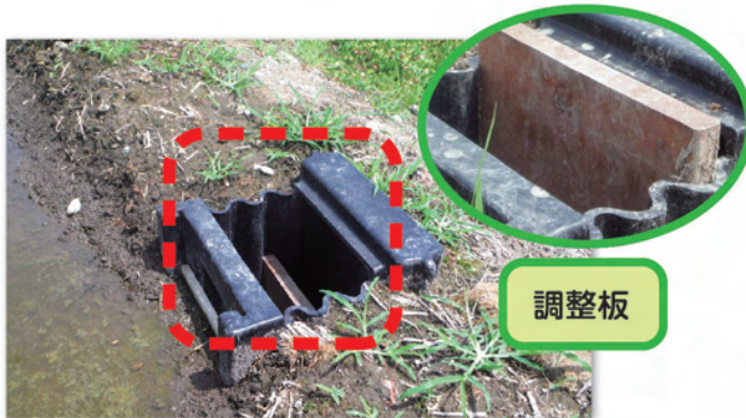
田んぼダムの調整マス
