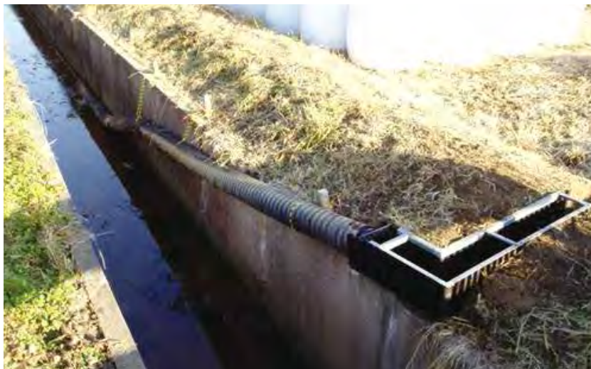
丸管タイプの水田魚道。
