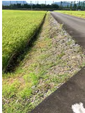
未対策の路肩
